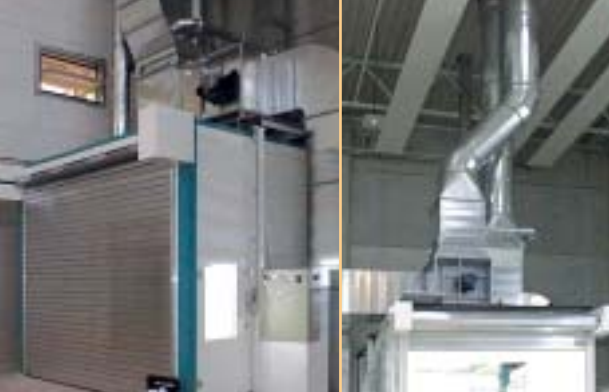
Lackierkabine mit integrierter Spritzwand und diagonaler Luftführung
