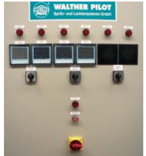
Schaltschrank mit Messumformern für die Füllstandsüberwachung
