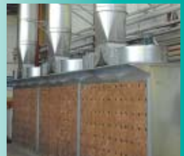
Spritzwände 90 W mit Abluftleitungen
