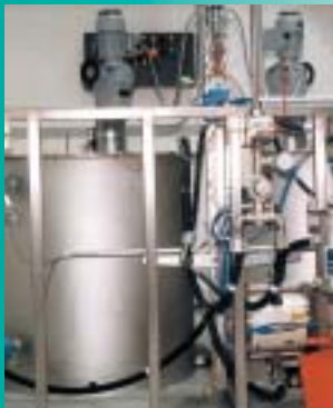
Farbmischbehälter aus Edelstahl bestückt mit Sonden zur Füllstandsermittlung im Einsatz in der Automobilindustrie
